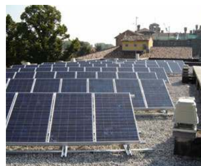
Impianto fotovoltaico del tipo "ad isola" autonomo dalla rete del gestore elettrico
